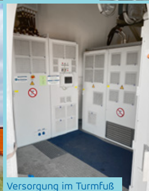
Versorgung im Turmfuß
