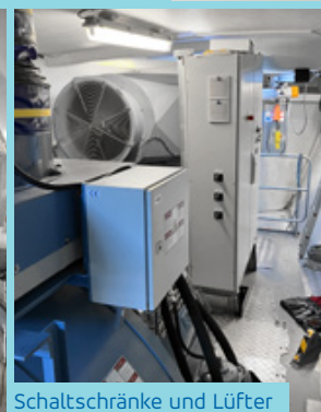
Schaltschränke und Lüfter
